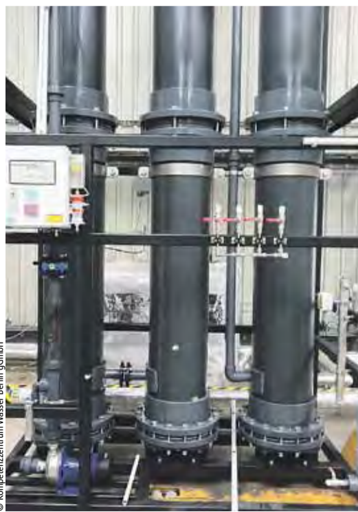
Anlage zur Wasserbehandlung mit Ozon im Klärwerk Ruhleben
