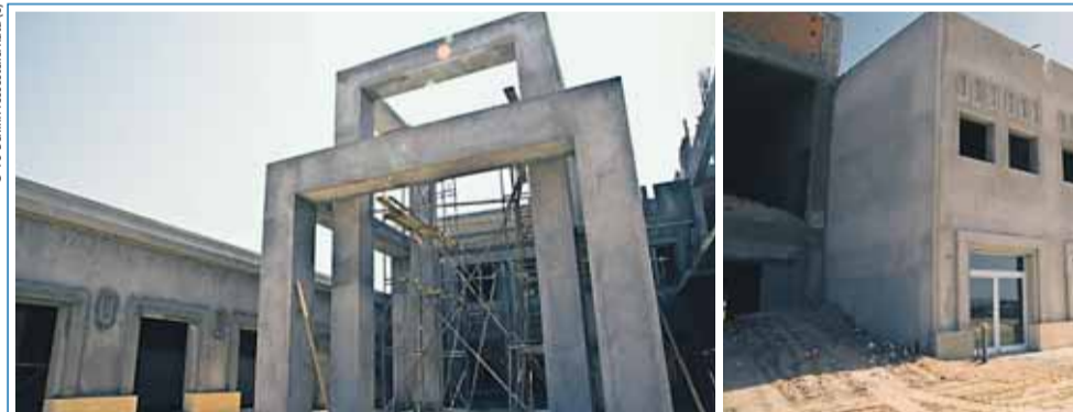
Der neue TU-Campus in El Gouna am Roten Meer hat eine Nutzfläche von rund 10000 Quadratmetern. Die Fotos oben zeigen den Baufortschritt im April 2010.
